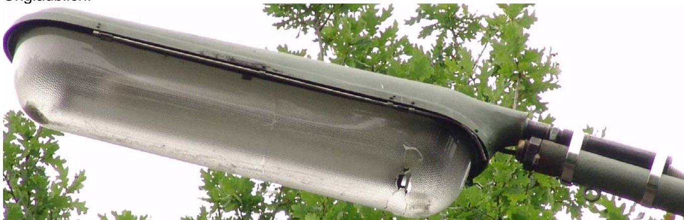
So sieht es bereits nach dem „Umbau“ in vielen Straßen der Nachbarschaft aus
