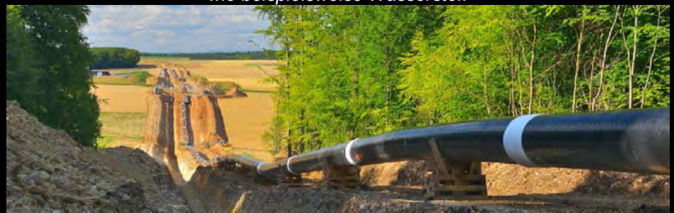
Eine Ferngasleitung schlängelt sich durchs Land. Bilder facebook
