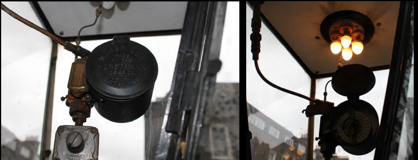
Mit der Horstmann-Clock, einer Schaltuhr, werden in London die meisten Gaslaternen ein- und ausgeschaltet.
