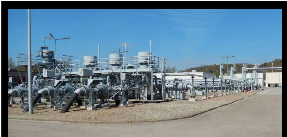
Oberirdische Anlagen des Gasspeichers Empelde bei Hannover Bild Gerd Fahrenhorst
